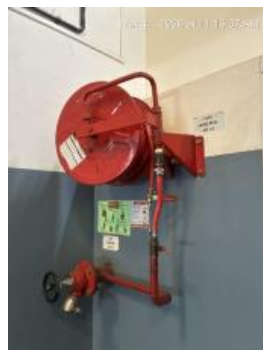
Fire hose reel area.JPG
