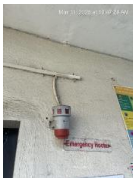
Fire Alarm hooter.JPG
