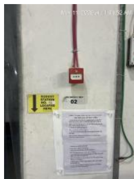
Fire Alarm call point.JPG
